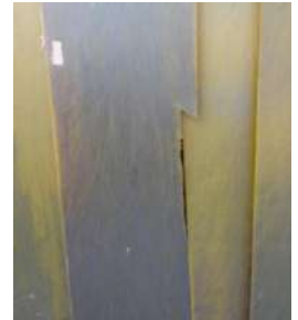
カーテンに5cm以上裂けてるところがある
