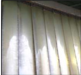
カーテンが汚れて奥が見えない
