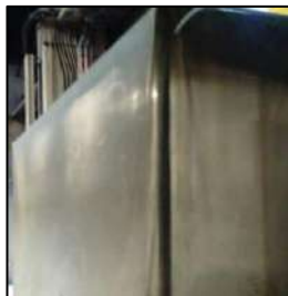
カーテンが汚れて奥が見えない
