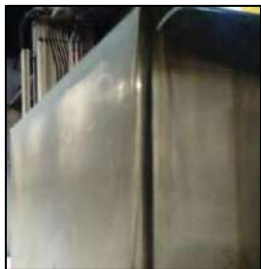
カーテンが汚れて奥が見えない
