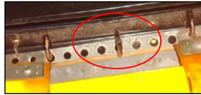
フレームの一部が変形している
