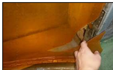
カーテンに5cm以上裂けてるところがある
