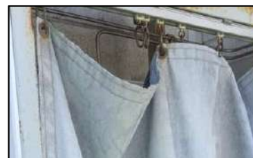
ハトメ部分が破れてランナーから外れている
