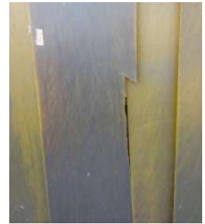
カーテンに5cm以上裂けてるところがある
